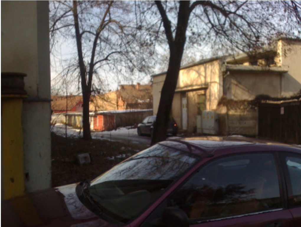
Vedere spre Postul Trafo dinspre curtea dintre cele două centrale termice
